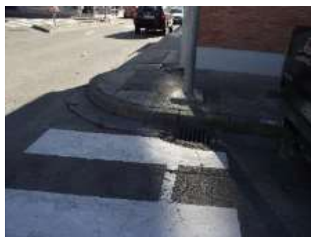
Imagen 58. Vista de un paso de peatones sin rebaje de bordillos
